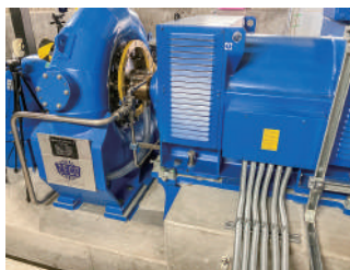
宝沢ほたる第二発電所 水車発電機
