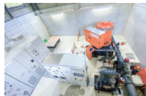
鹿児島県さつま町泊野川水力発電所 立軸4射ペルトン水車 530 kW・2022年3月運転開始
