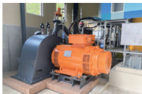
福井県坂井市川上小水力発電所 横軸2射ペルトン水車 130 kW・2021年8月運転開始
