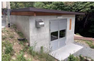
◀兵庫県宍粟市黒土川小水力発電所 (取り外し可能なCLT材屋根とRC半地下構造建屋)
