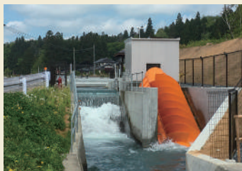
八幡沢発電所(19.9 kW) 農業用水路に発電設備を導入
