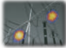
部分放電調査
